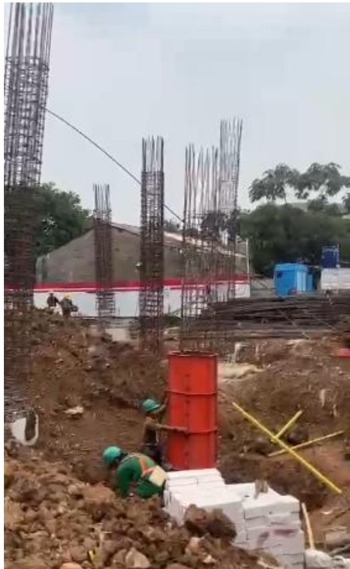
Gambar 2. Pekerja Tidak Menggunakan Sarung Tangan
