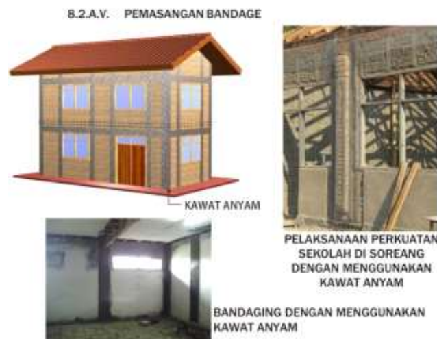
Gambar 12. Perbaikan Dinding Retak Akibat Guncangan Gempa Dengan Bandage Kawat Anyam (Sumber: Boen (2020))
