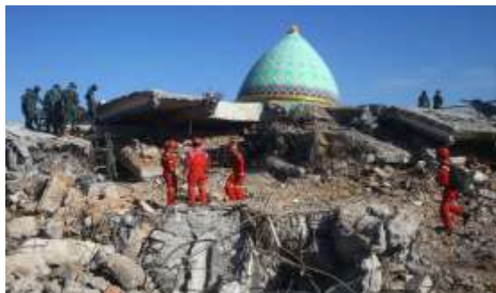
Gambar 2. Bangunan Roboh Akibat Guncangan Gempa Lombok 2018 (Masjid Jamiul Jamaah Kec. Pemenang Lombok Utara)
