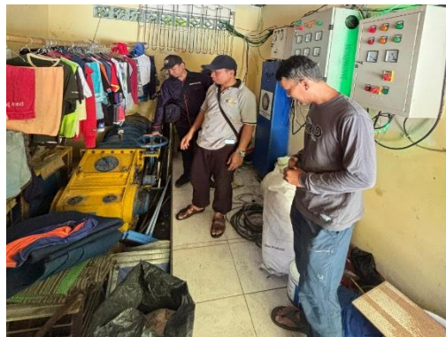
Gambar 2. Ruang generator PLTMH dan controller PLTS
