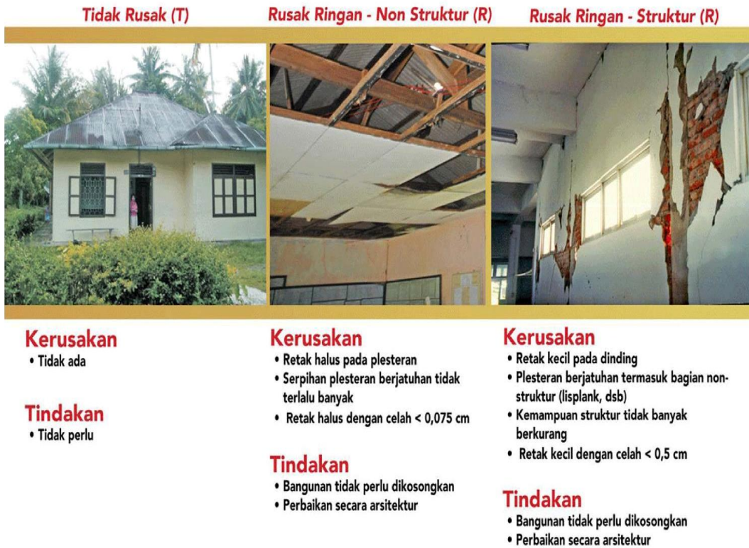
Gambar 1 Bangunan Tidak Rusak Sampai Rusak Ringan dan Tindakan yang Dilakukan
