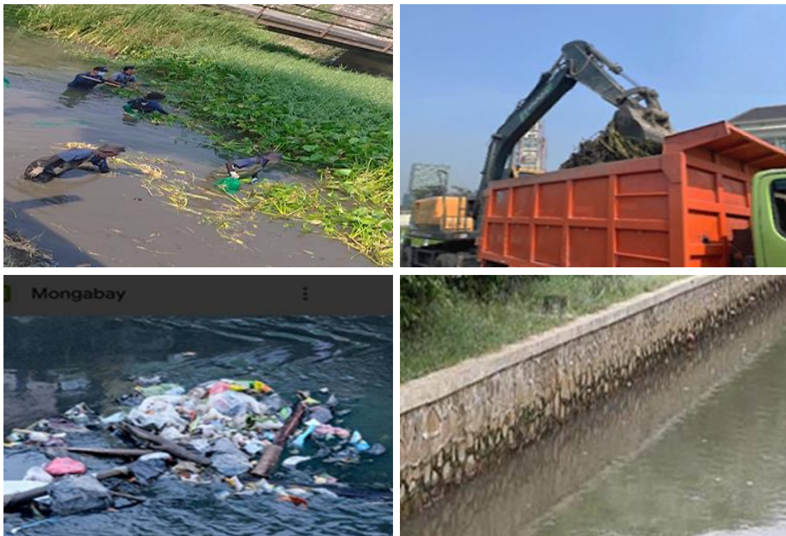
Gambar 2. Kiri Atas: Partisipasi Mahasiswa dan Warga Terjun Langsung Membersihkan Sampah dan Enceng Gondok; Kanan Atas: Penggunaan Alat Berat dalam Membantu Membersihkan Sampah di Sungai; Kiri Bawah: Kondisi Sungai sebelum Program Pembersihan; Kanan Bawah: Kondisi Sungai sesudah Dibersihkan oleh Masyarakat bersama Mahasiswa.
